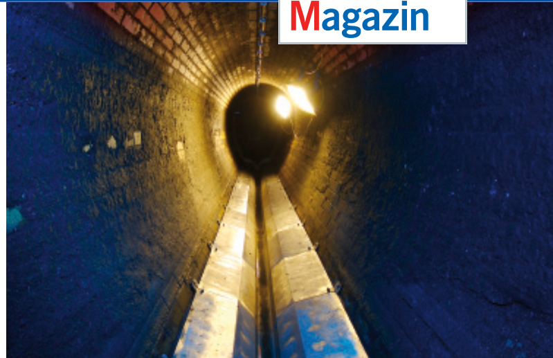
Bild 1: Zwei Drittel der 20 in Deutschland installierten Anlagen zur Abwasserwärmegewinnung setzen Wärmeübertrager auf der Kanalsohle ein.
